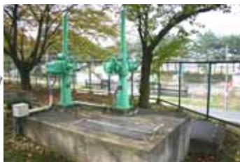
雨水最終放流口 非常用水門
